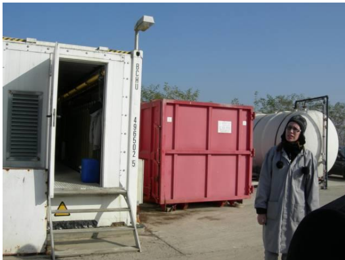
Imaginea 2-8: Stație epurare levigat prin osmoza inversă
