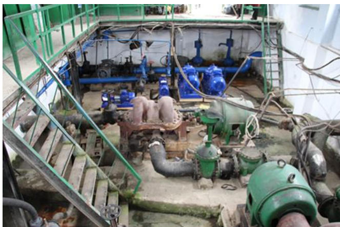
Figura 8-10: Stația de pompare de treapta I, SP1
