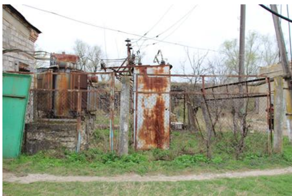
Figura 8-12: Gospodăria energetică existentă
