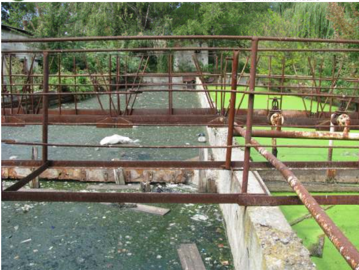
Imaginea 11: Stația de epurare Costești
