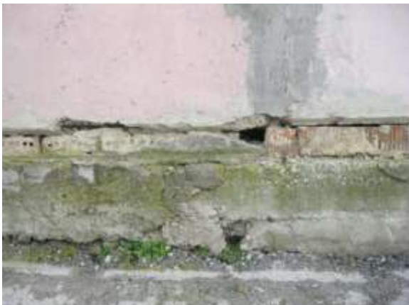
Imagine 5: Alge și mușchi apărute pe soclul clădirii, în urma împrăscării cu apă
