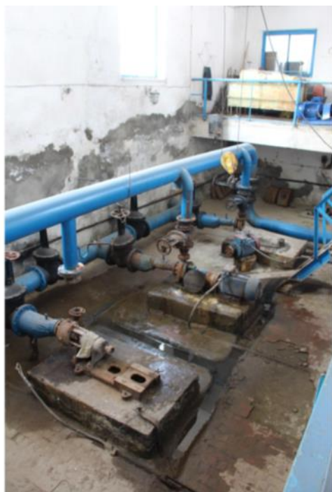
Figura 5-4: Stația de pompare
