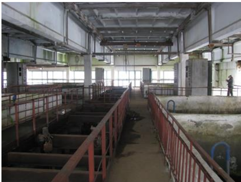
Figura 6-5: Starea instalației de filtrare
